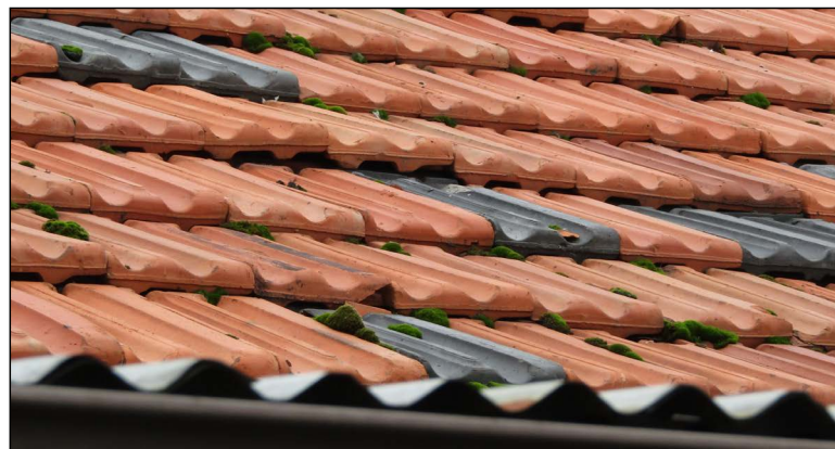
Figuur: op het dak van de schuur zijn veel kieren, waardoor vleermuizen onder dit dak een mogelijke verblijfplaats kunnen hebben.
