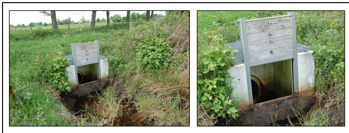
Figuur 5 Schotbalkstuw in de BS 87 even ten zuiden van het Kerkpad (stuwnummer 235857541).
