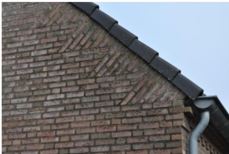
Vlechtingen in het metselwerk langs de dakrand.
