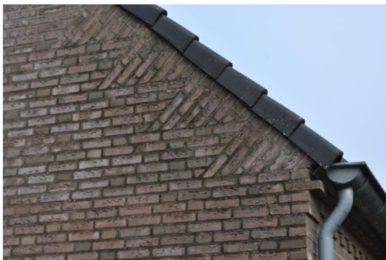
Vlechtingen in het metselwerk langs de dakrand.
