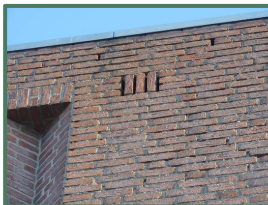
Open stootvoegen in bebouwing achter Binderseind 9
