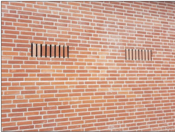
Figuur 12. Geschikte opening/potentiële verblijfplaats voor vleermuizen
