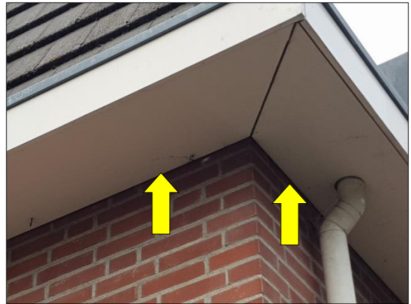
Figuur 13. Geschikte opening/potentiële verblijfplaats voor vleermuizen
