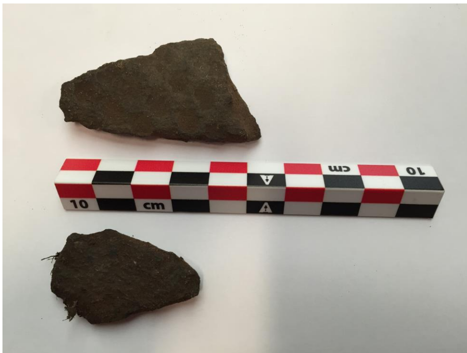
Afbeelding 5: Aangetroffen asbestverdacht plaatmateriaal in ABG8
