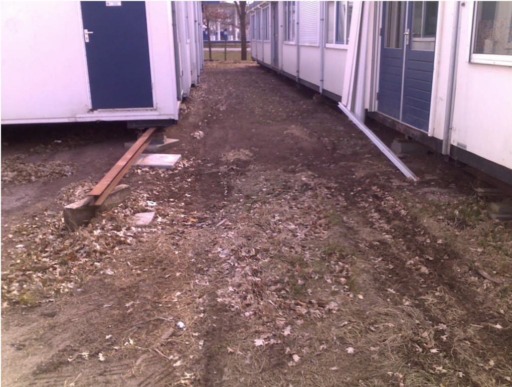
Foto Directbouw, tussen cabins in, veel puin
