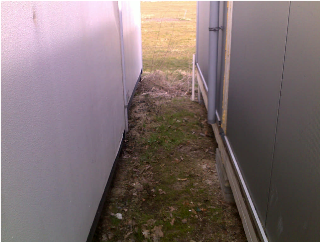
Foto Directbouw, tussen cabins in, veel puin
