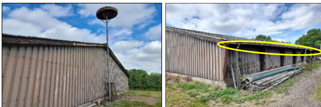
Figuur 8. Ooievaarsnest tegen de fruitschuur welke in de afgelopen jaren in gebruik was (l) en mogelijke invliegopeningen voor de steenuil (r).
