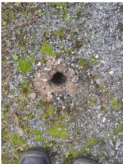
Figuur 3.5: Hol in schouwpad (km 40.18).
