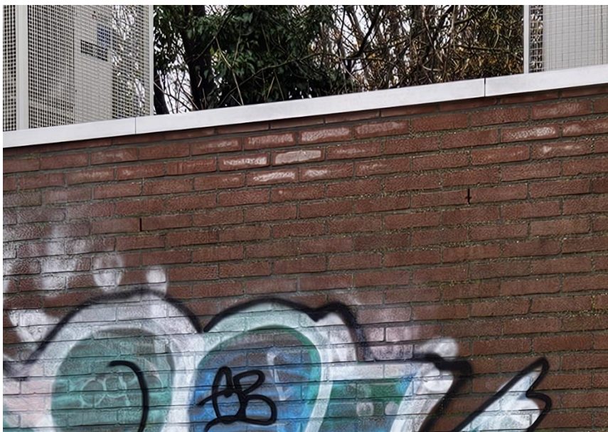
Figuur 12: open stootvoegen in het transformatorhuisje
