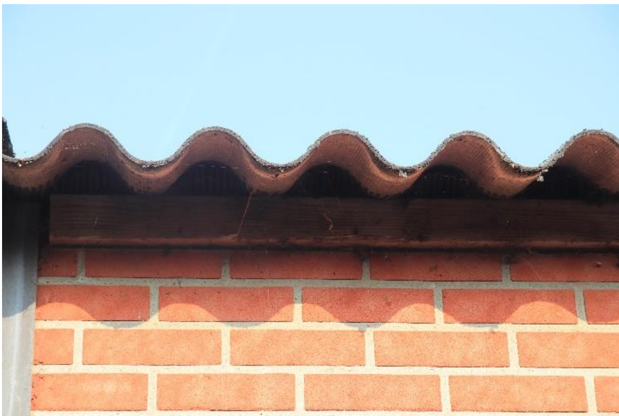
Foto 1: De daken zijn geheel ontoegankelijk voor huismussen en/of gierzwaluwen.
