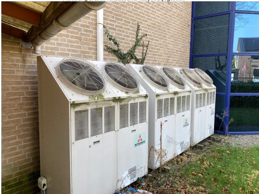
• Afbeelding 9: airco ventilatieunits nabij bedrijfsgebouw
