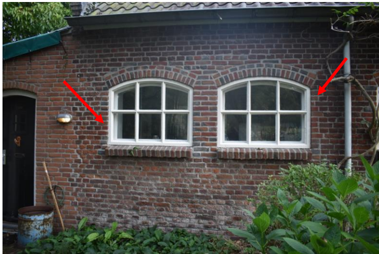
Twee betonnen zesruits stalvensters. De rode pijlen wijzen het inboetwerk aan.
