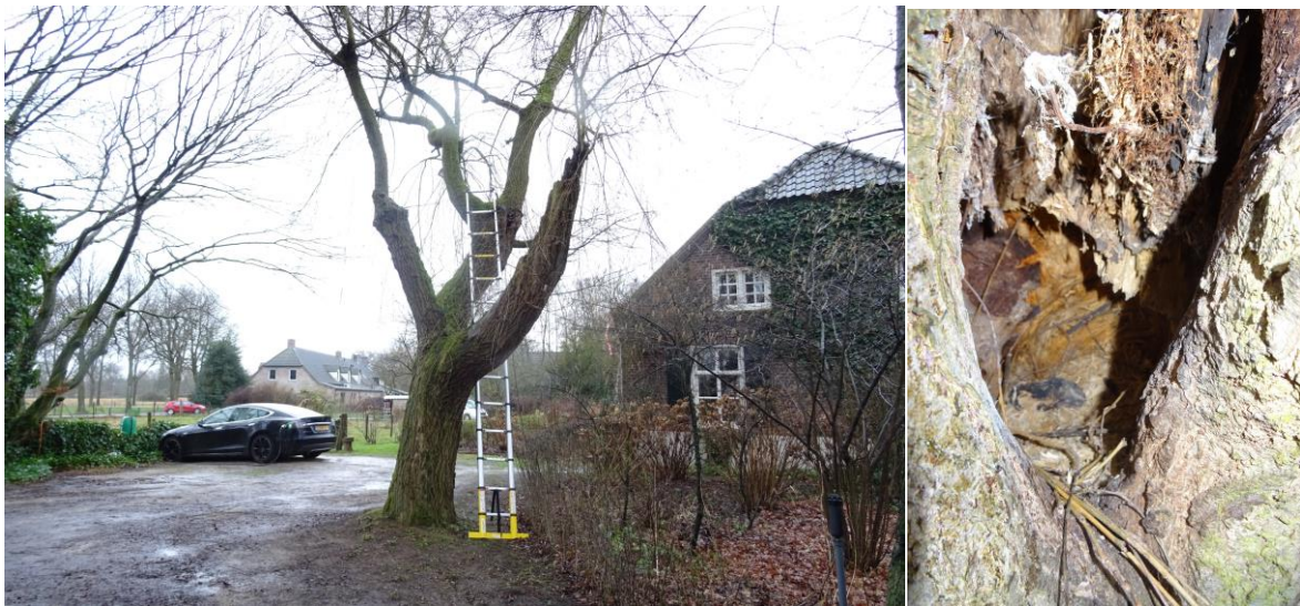
Afbeelding 11 en 12: Vogelschroot onder het dak van de te verbouwen langgevelboerderij. Bron: BNL advies. Datum: 31-01-2022
