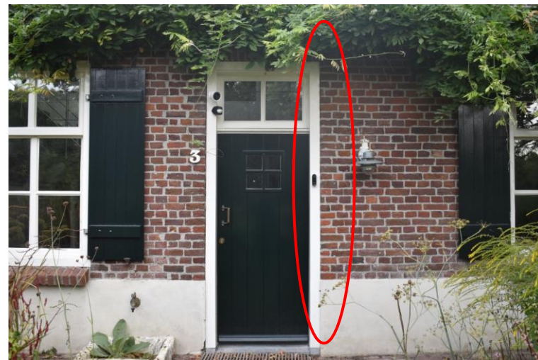
Houten voordeur met tweeruits bovenlicht. Rood omcirkeld het gezaagde metselwerk.
