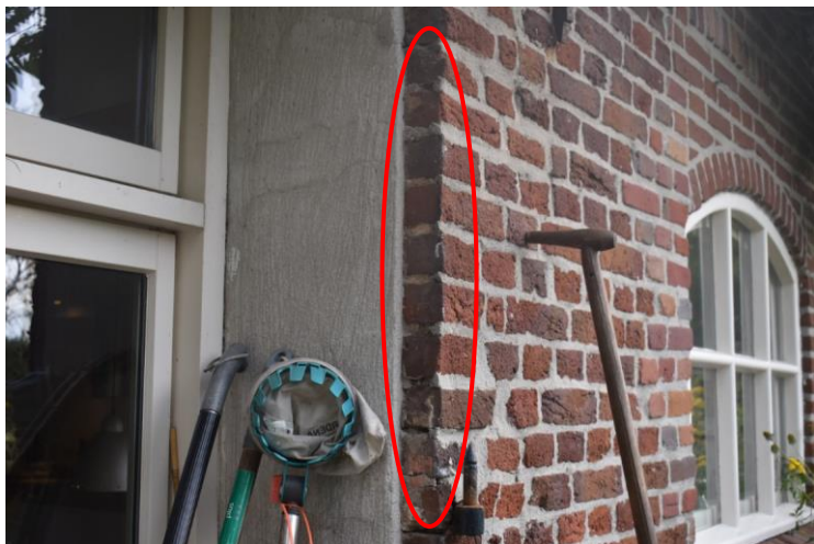
Rood omcirkeld gezaagde bakstenen.
