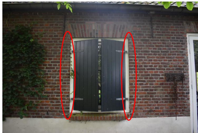
Rood omcirkeld de sporen in het metselwerk.
