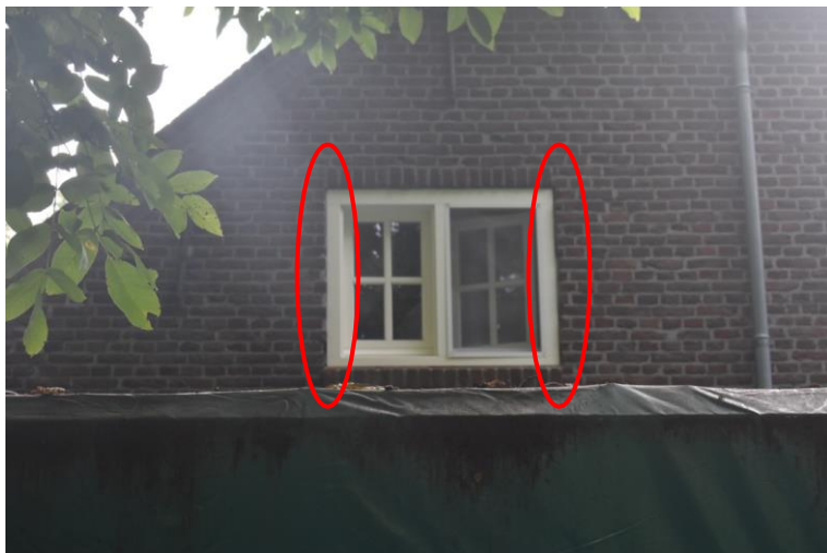
Rood omcirkeld de sporen in het metselwerk.
