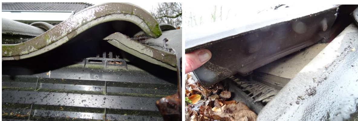
Afbeelding 9 en 10: Vogelschroot onder het dak van de te verbouwen langgevelboerderij. Bron: BNL advies. Datum: 31-01-2022
