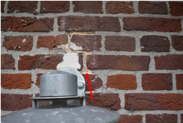
De rode pijl wijst de kalkhoudende voeg aan.
