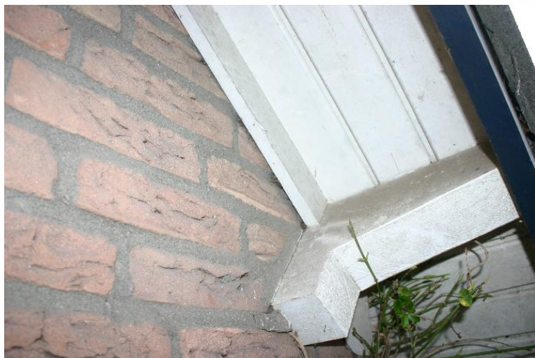
Figuur 4.4.3. Tussen de onderzijde van de dakoverstek en de gevel bevinden zich kieren.
