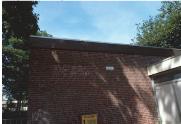
Oo meerdere plaatsen zijn open stootvoegen in het gebouw.
