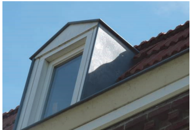
Plangebied 14, Losse dakpannen bij een van de dakkapellen.
