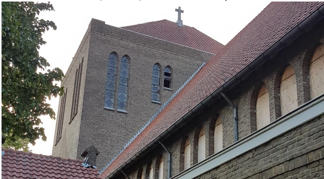
Foto 2. Kerktoeren met kapotte ruiten gezien vanaf de noordwestzijde
