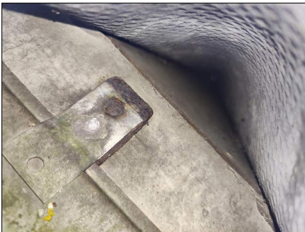
Figuur 2 Onder de golfplaten dakbedekking van de grote schuur aan de Zuiderweg 20 is onvoldoende ruimte aanwezig (+/- 3 cm) waardoor de huismus geen nestlocatie kan realiseren.
