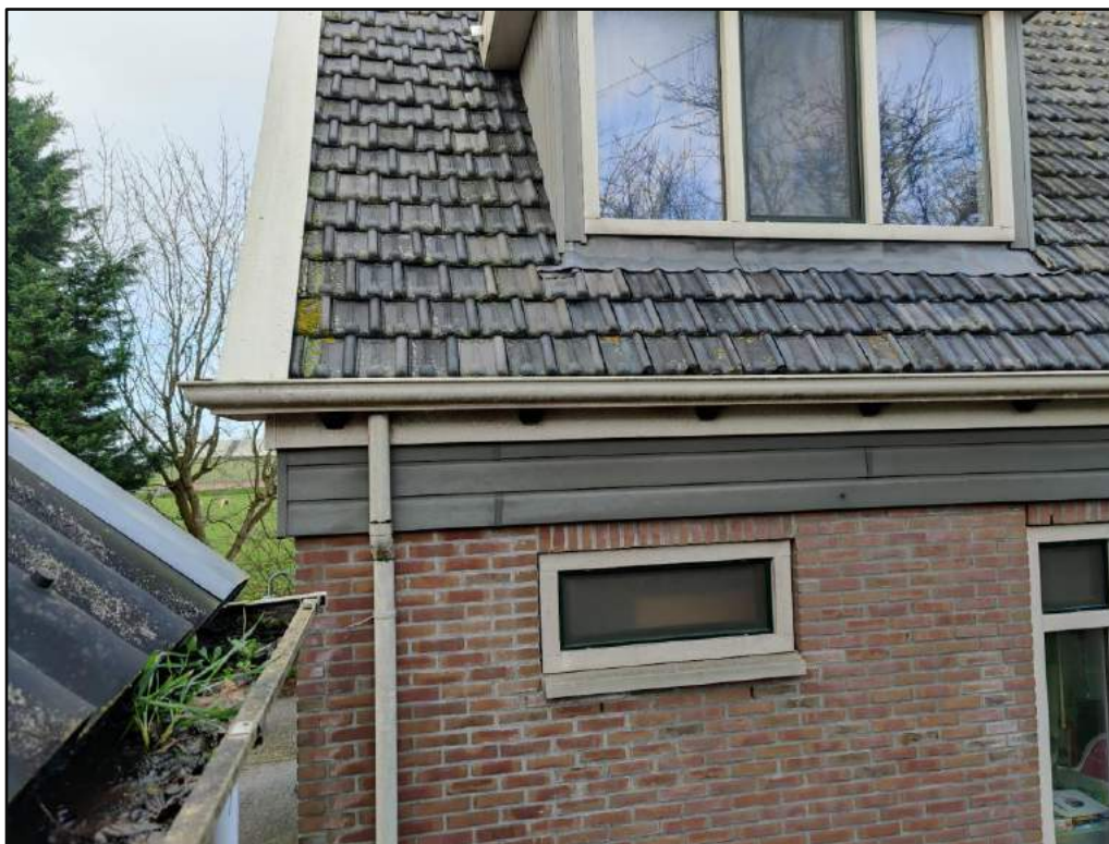
Figuur 1 De dakpannen op de woning aan de Zuiderweg 20 bieden, vanwege hun vorm, geen ruimte voor de huismus om een nestlocatie te realiseren.
