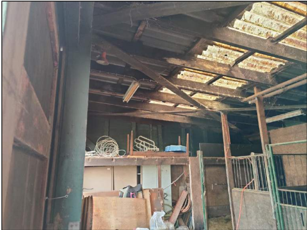
Figuur 3 De golfplaten dakbedekking op de kleine schuur is niet gelegen op dakbeschoot. Hierdoor kunnen huismussen geen nestlocatie realiseren onder de golfplatendakbedekking.
