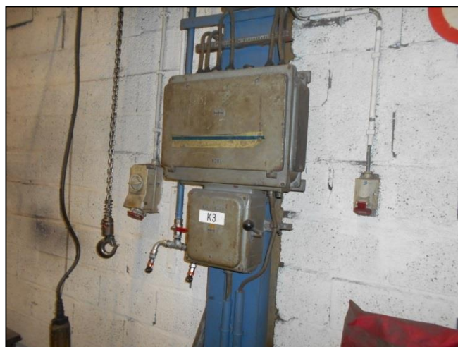
Foto 16: Gietijzeren elektrakasten (uitgesloten)
