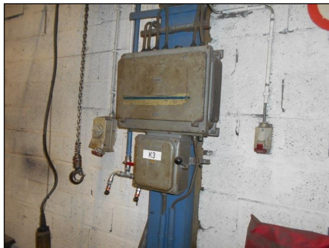
Foto 16: Gietijzeren elektrakasten (uitgesloten)
