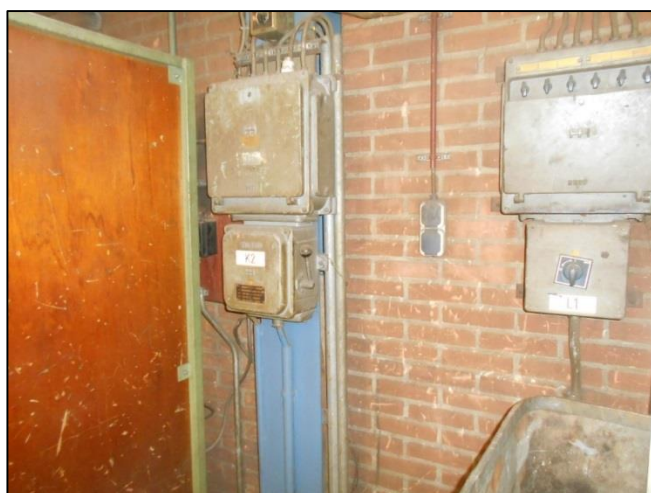
Foto 4: Gietijzeren elektrakasten (uitgesloten)
