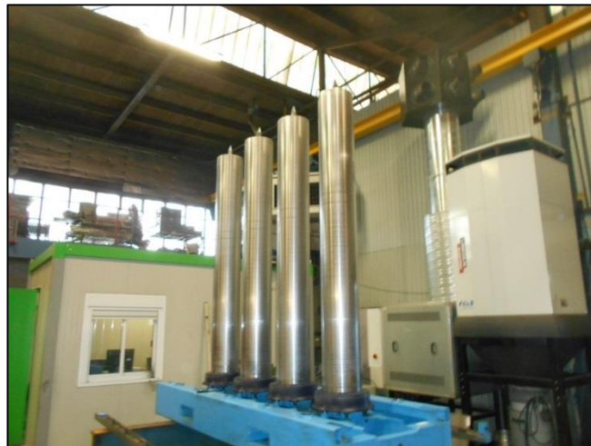
Foto 14: Werkplaats: CV-ketel (asbestvrij)
