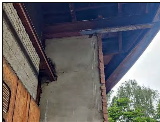
Afbeelding 6: Meststrepen op gevel
