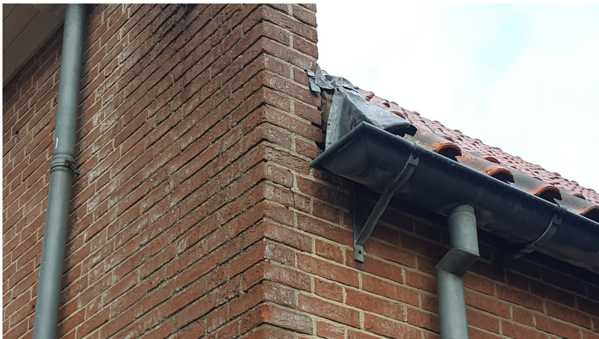
De kier linksboven de dakgoot op de hoek van achterzijde en het 3e Walsteeg biedt ook toegang tot mogelijke verblijfplaatsen voor vleermuizen. Foto. B. Verhoeven | Ecoresult BV
