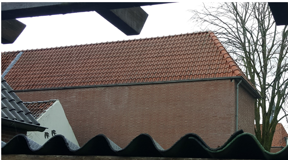
Het grote gat in de noordmuur van de uitstekende uitbouw net onder de dakgoot. Ook dit gat biedt toegang tot mogelijke verblijfplaatsen van vleermuizen. Foto. B. Verhoeven | Ecoresult BV
