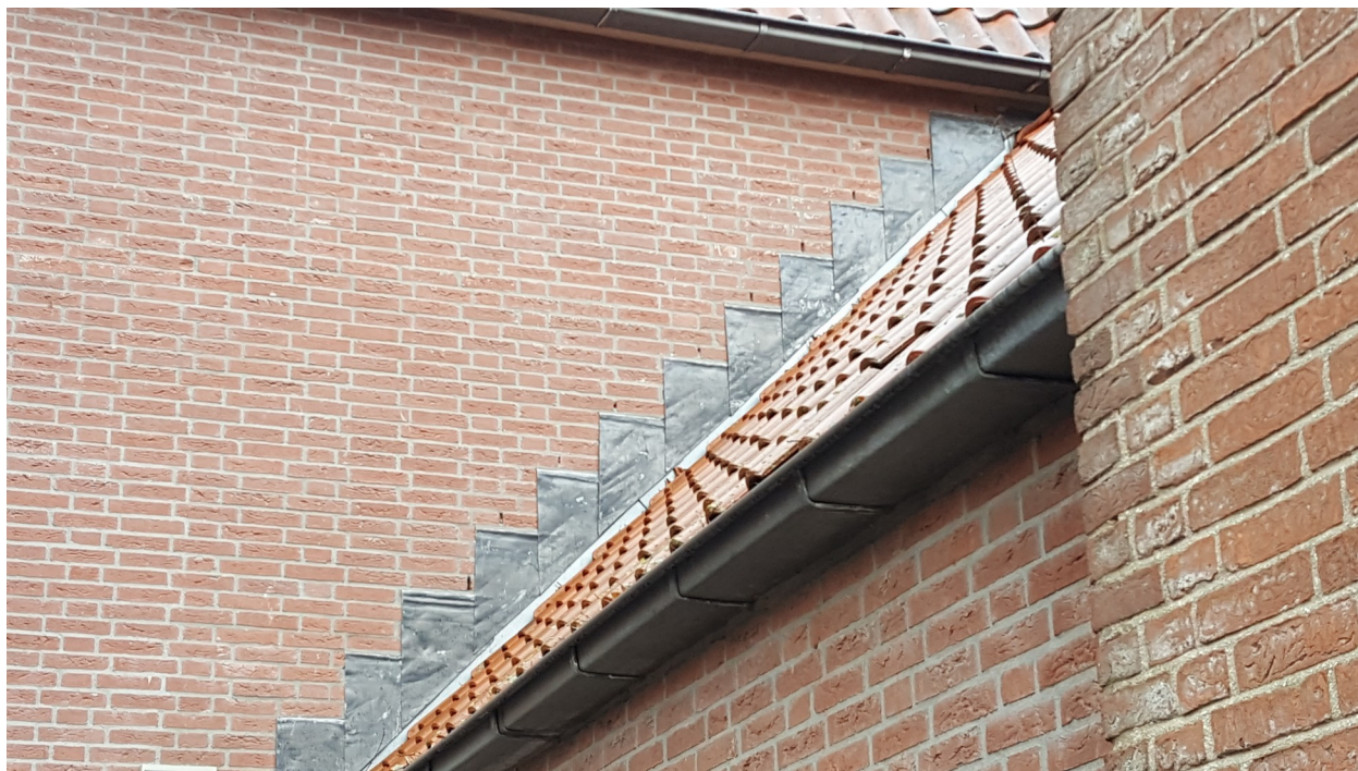
In de zijmuur van de uitstekende uitbouw van nr. 31 bevinden meerdere open stootvoegen die toegang bieden tot mogelijke verblijfplaatsen in de luchstpouw. Foto. B. Verhoeven | Ecoresult BV
