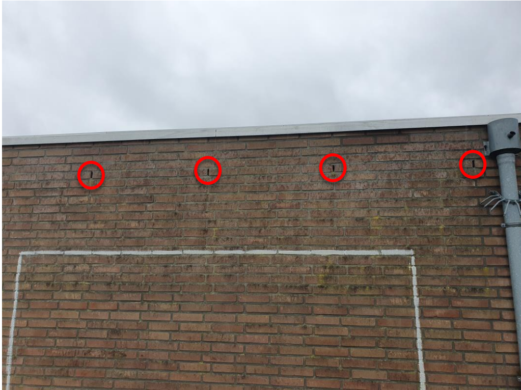
Figuur 3 Open stootvoegen in de gevel van de Van Heemstraschool.
