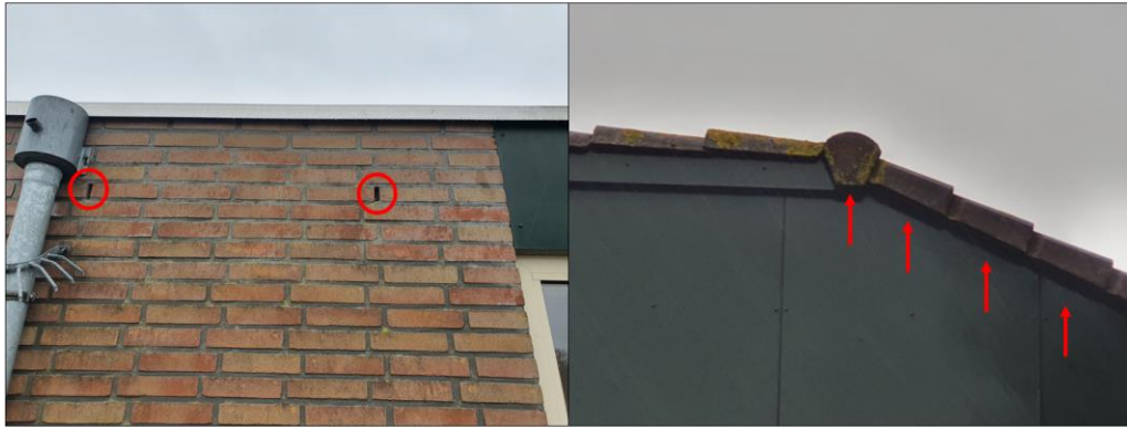
Figuur 4 De Van Heemstraschool met rood omcirkeld open stootvoegen (L) en kierende kantpannen en nokvorst (R).
