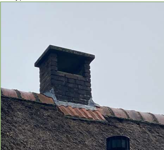
Afb. 2.5 - De nokpannen en het daklood sluiten goed aan en de schoorsteen is ongeschikt voor vleermuizen door de gladde buizen in het rookkanaal.
