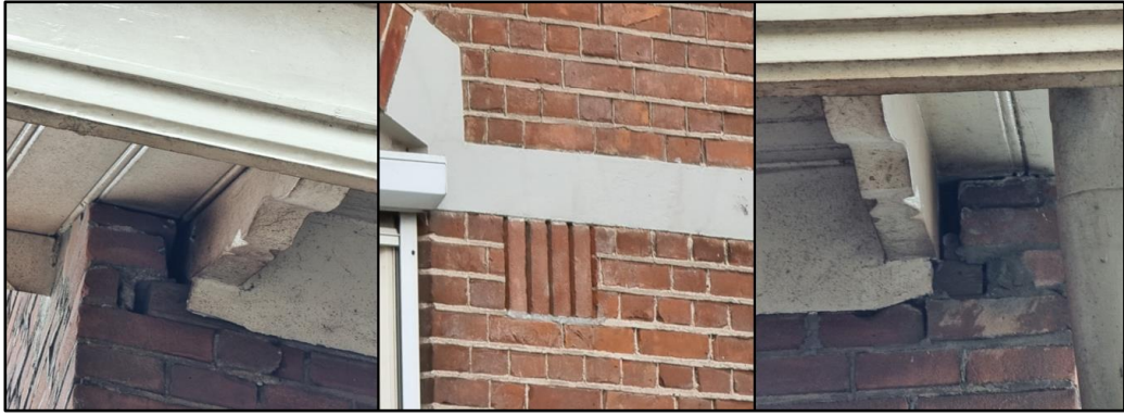
Figuur 1.3 Middels ventilatie voegen en open ruimtes tussen gevel en dakrand kunnen vleermuizen toegang krijgen tot binnenruimtes waardoor potentie voor vorengenoemde soorten niet uitgesloten kan worden.
