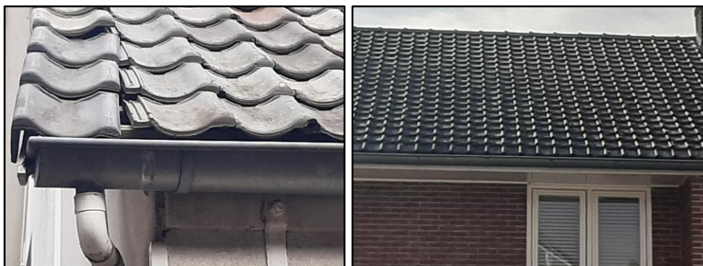
Figuur 5 De toegang tot de onderste rij dakpannen van woning A wordt geblokkeerd door een houten balk (links). De dakpannen van woning B zijn plat, waardoor er geen ruimtes onder aanwezig zijn waar huismussen zouden kunnen nestelen.
