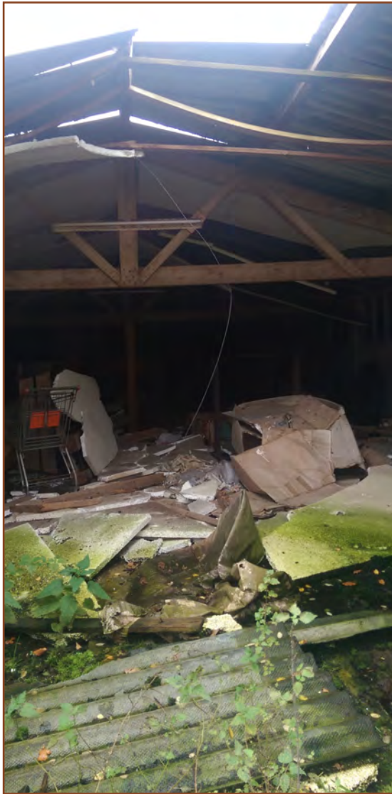
Afb. 3.4: De vervallen stal met gedeeltelijk ingestort dak. In het gebouw ligt veel puin, isolatiemateriaal etc.
