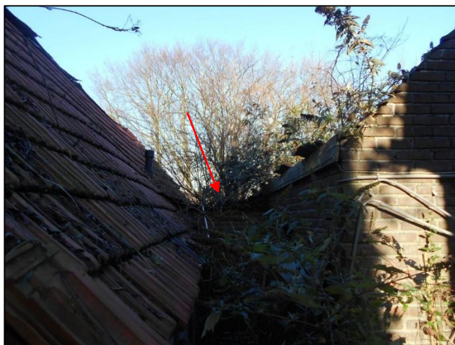
Foto 31: Woning 2: Golfplaten afdak (M03AA)
