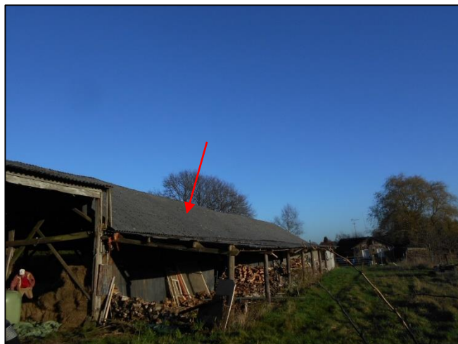
Foto 64: Schuur 2: Golfplaten dak (M03AZ)
