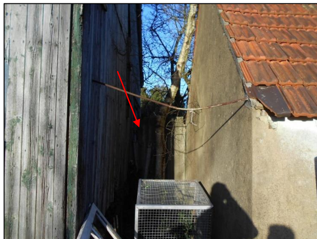
Foto 52: Naast en achter schuur 1: Golfplaten wand (M03AZ)
