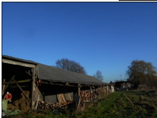
Schuur 2: Golfplaten dak (M03AZ)
