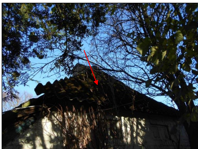
Foto 29: Woning 2: Golfplaten dak (M03AA)
