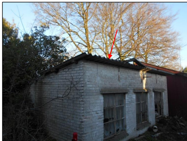
Foto 70: Schuur 3: Golfplaten dak (M03AZ)
