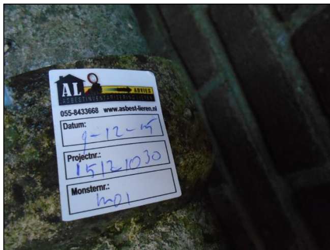
Foto 6: Afgebrande woning: Rookgasafvoer (M01AA)
