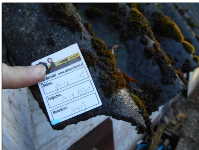
Foto 27: Woning 2: Golfplaten dak (M03AA)
