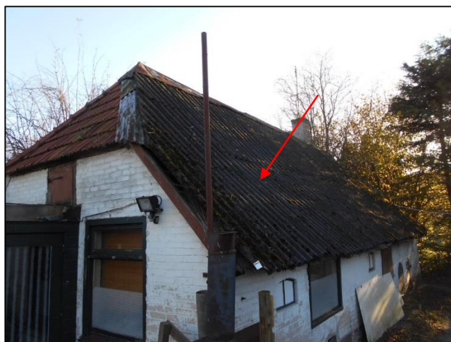
Foto 28: Woning 2: Golfplaten dak (M03AA)
