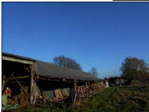
Schuur 2: Golfplaten dak (M03AZ)
