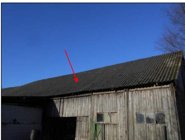
Foto 53: Schuur 2: Golfplaten dak (M03AZ)
