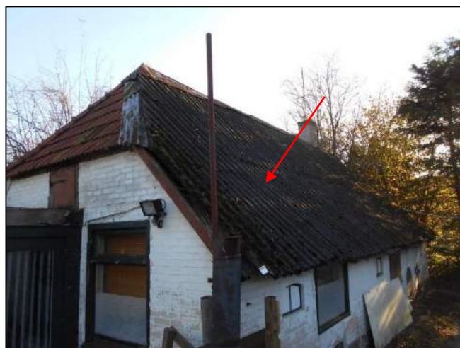
Foto 28: Woning 2: Golfplaten dak (M03AA)
