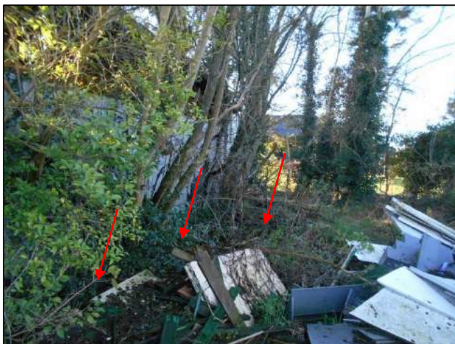
Foto 63: Naast schuur 2: Restanten wandbeplating (M04AZ)
