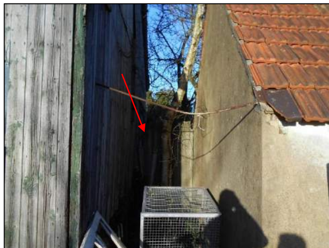
Foto 52: Naast en achter schuur 1: Golfplaten wand (M03AZ)
