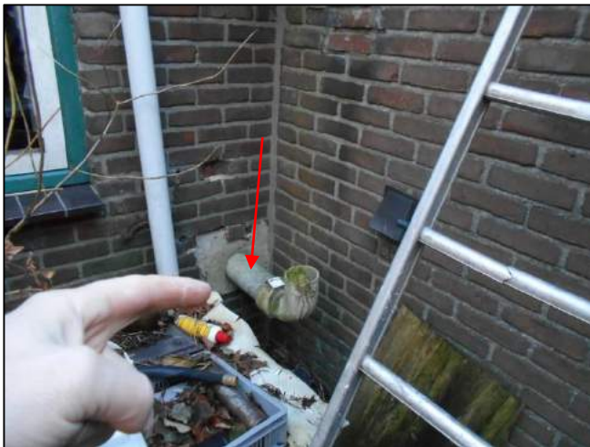
Foto 7: Afgebrande woning: Rookgasafvoer (M01AA)
