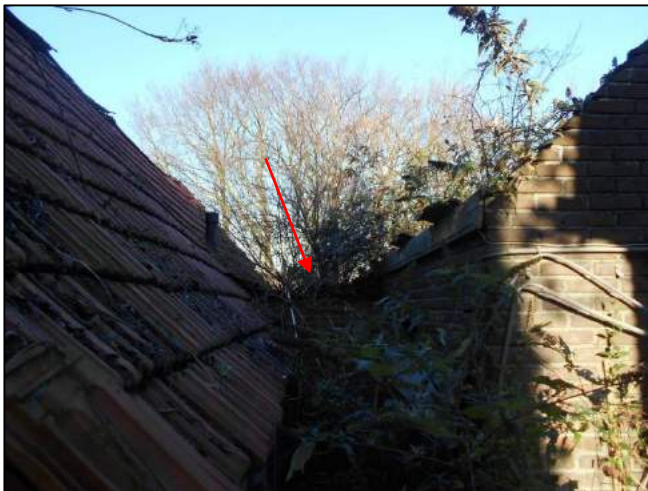
Foto 31: Woning 2: Golfplaten afdak (M03AA)
