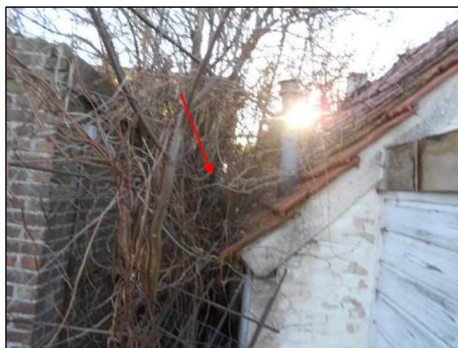
Foto 30: Woning 2: Golfplaten afdak (M03AA)
