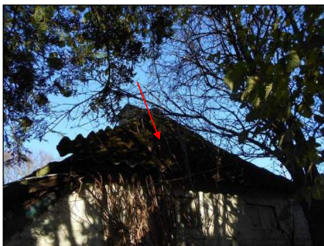
Foto 29: Woning 2: Golfplaten dak (M03AA)
