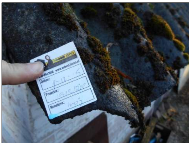
Foto 27: Woning 2: Golfplaten dak (M03AA)
