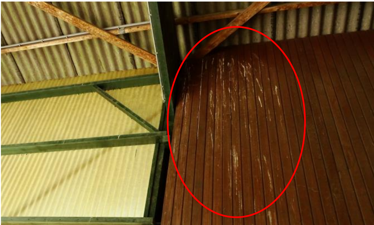
Figuur 5.4. Poepsporen aangetroffen tegen de zijwand van de voormalige zoutloods aan de binnenzijde.
