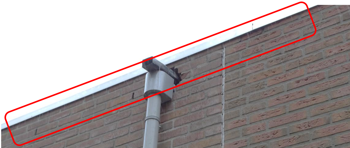
Figuur 5.8. Openstootvoegen, ruimte onder de daktrim en een gat bij de regenpijp aan de achterzijde van het pand van het Witte kruis.
