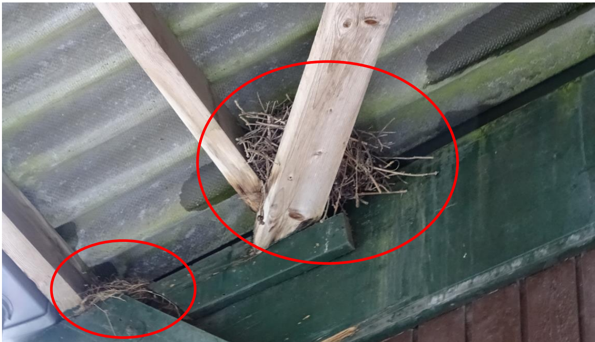
Figuur 5.2. Vogelnesten aangetroffen in de oostelijke hoek van de voormalige zoutloods.
