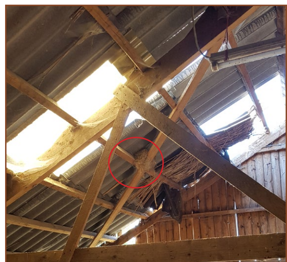
Afb. 2.5: Eén van de huismussen nesten in de koeienstal (westzijde)
