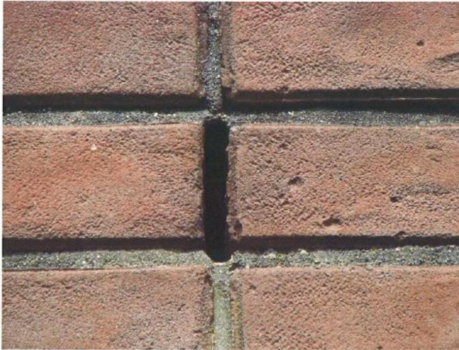
Foto 21: Ventilatieopeningen vormen voor vleermuizen een toegang tot de spouwmuur.
