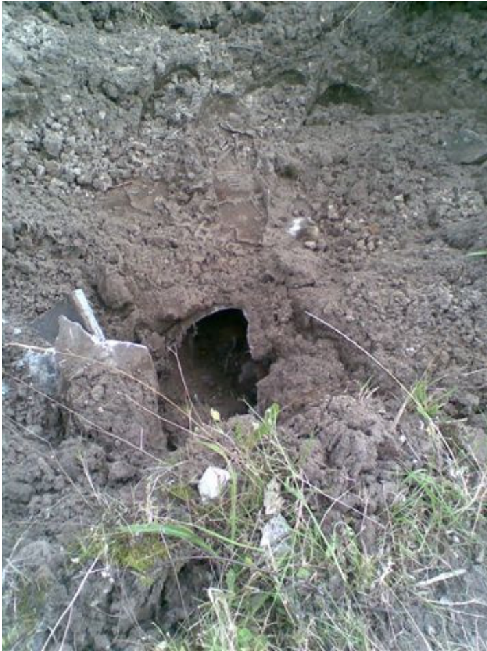
Foto 3 (tussen inspectiegaten 3 en 4)
