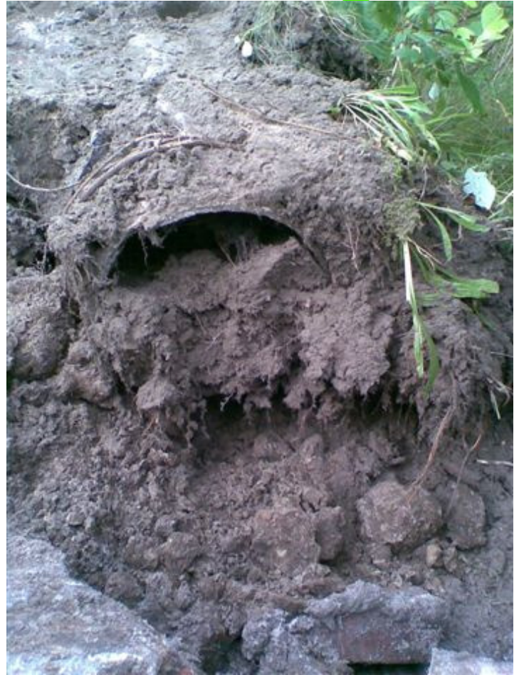
Foto 4 (tussen inspectiegaten 3 en 4)
