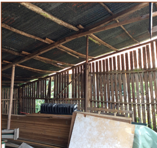
Afb. 2.4: Binnenzijde gebouw C. Het gebouw verkeert in slechte staat en is deels vervallen.
