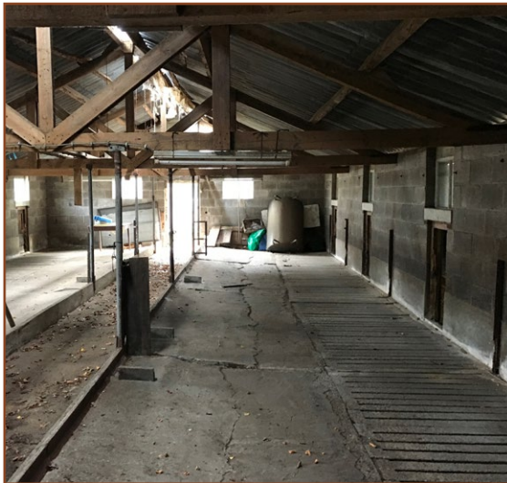
Afb. 2.2: Een van de schuren in verval staat. De nokplaten ontbreken, evenals enkele stalramen.
