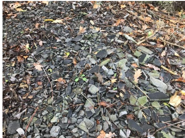
Figuur 10: Gebroken golfplaten
