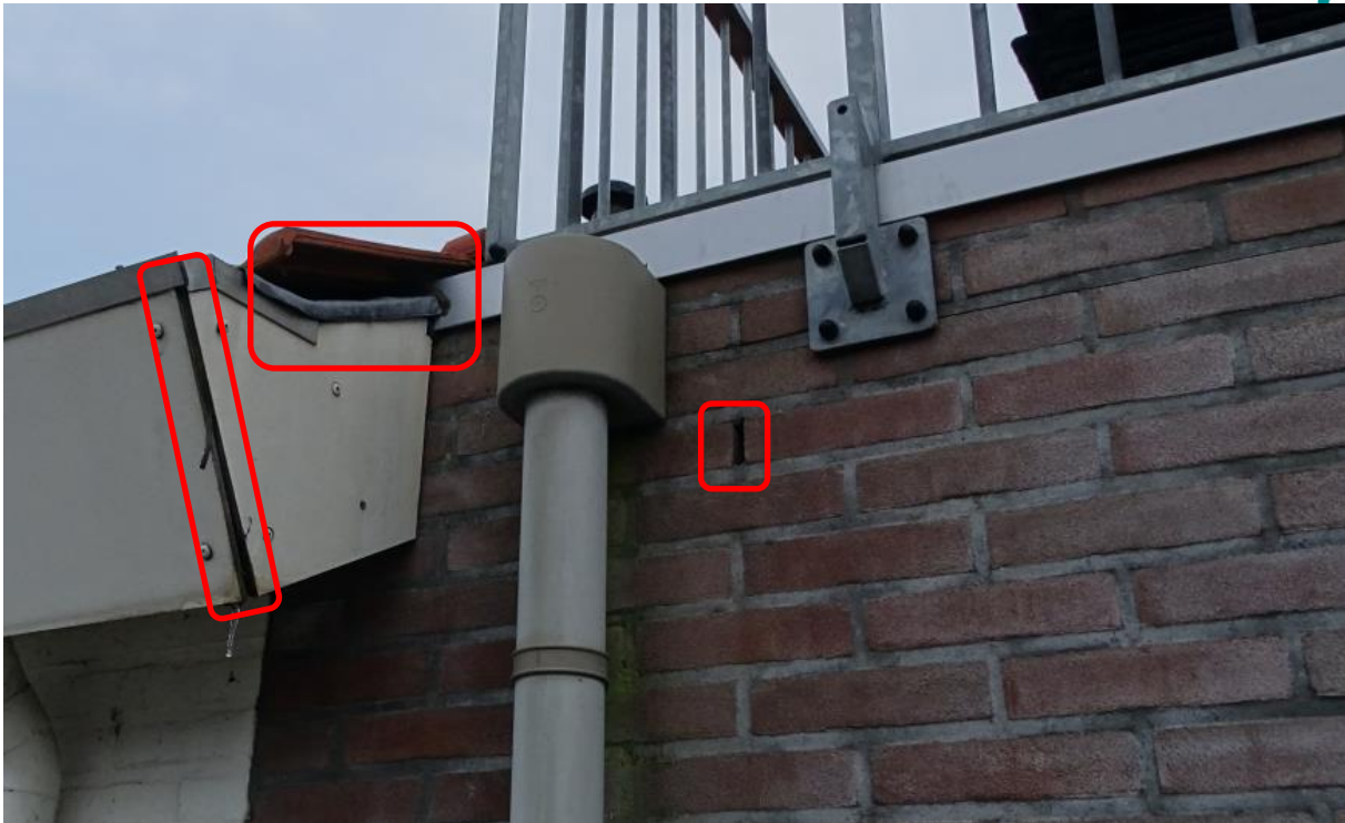
Figuur 5.6. Invliegopeningen voor vleermuizen onder de boeiranden, onder de dakpannen en via open stootvoegen.
