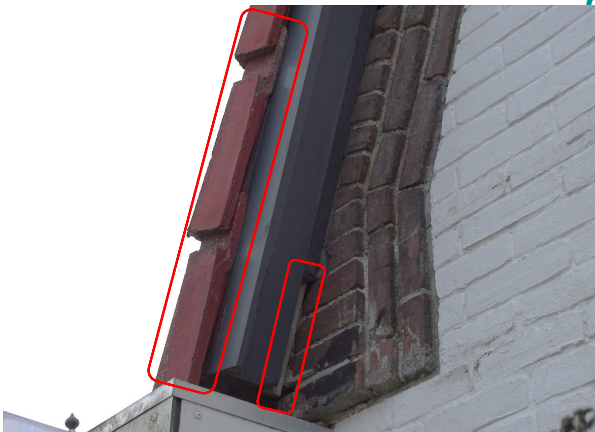
Figuur 5.4. Potentiële invliegopeningen voor vleermuizen onder de gevelpannen.
