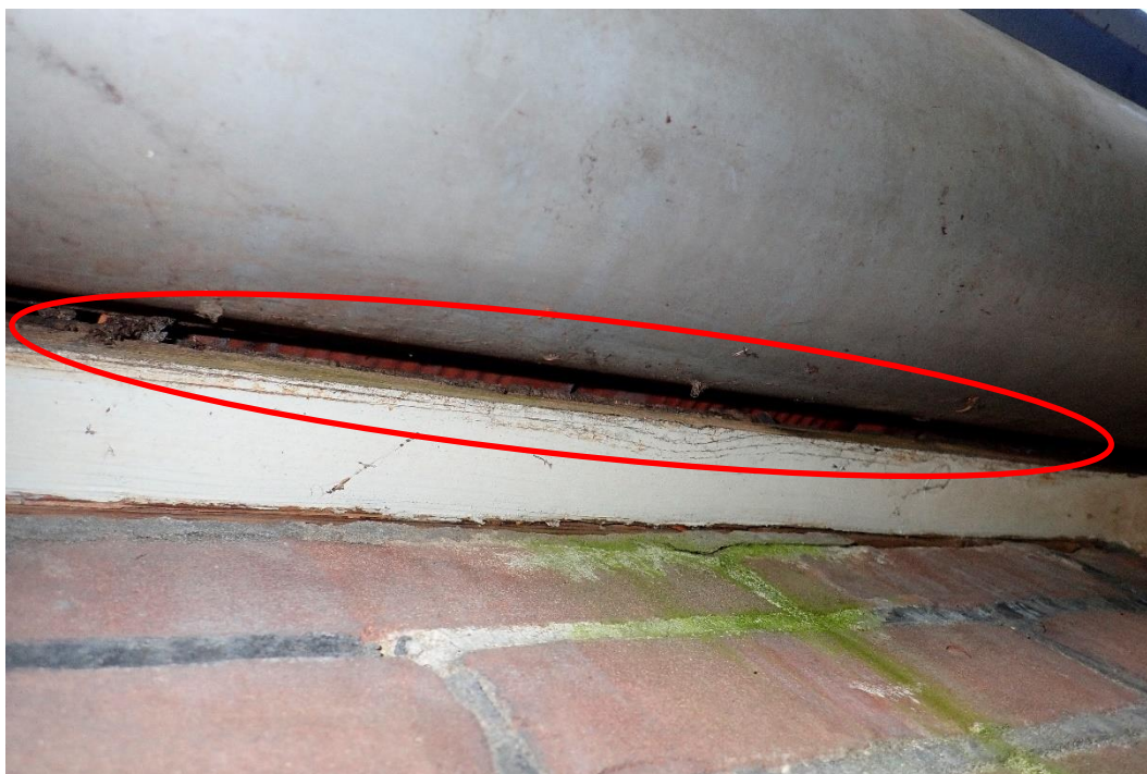
Figuur 5.6. Kieren onder dakgoot bieden toegang tot potentieel verblijf in dakruimte en spouw.
