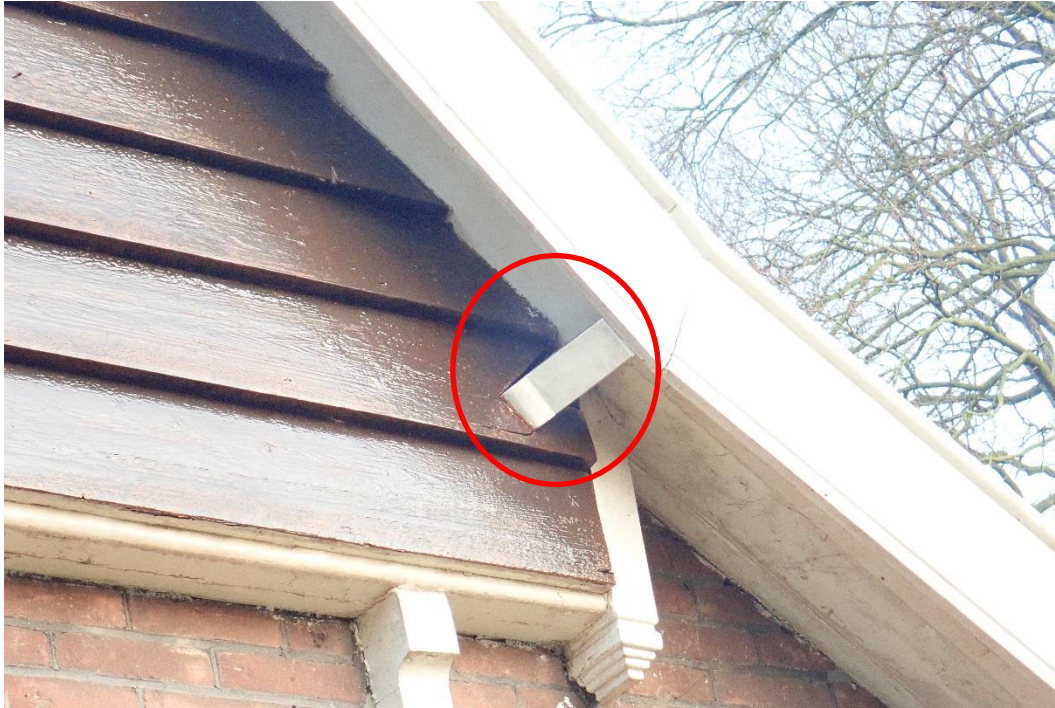
Figuur 5.3. kieren naast gevelbetimmering achterzijde woningdeel 439a.
