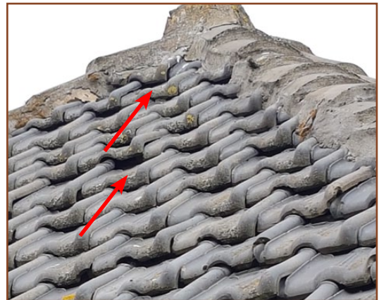
Afbeelding 7: Nog meer openingen in de vorm van opstaande en scheefliggende pannen.
