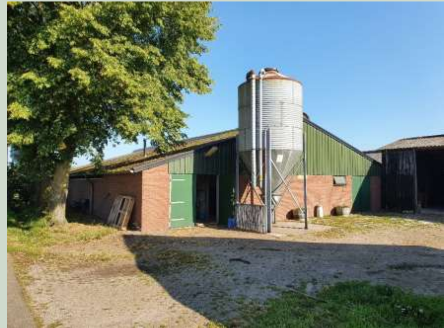
Te slopen stal / kapschuur
