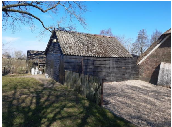
Foto 2: Schuur (campingwinkel) met verweerd asbest dak met ontbrekende dakgoot, gezien in noordelijke richting
