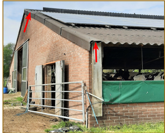
Afbeelding 5: 2 Op een aantal plekken zijn ruimtes onder de dakplaten aanwezig waar vogels zoals huismus en spreeuw kunnen nestelen.
