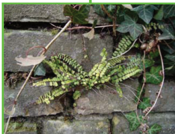
Foto 5: Steenbreekvaren op muur van gebouw 6.
