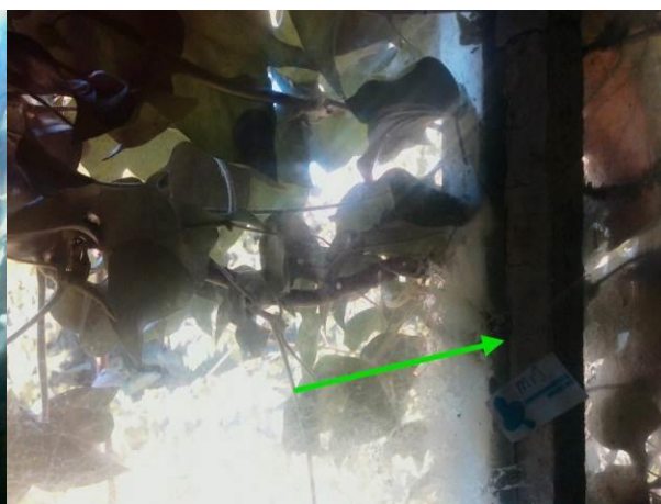
Foto 55 | stopverf /vulpasta in betonramen
