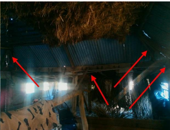
Foto 6 | restanten plafondbeplating tegen balklaag
