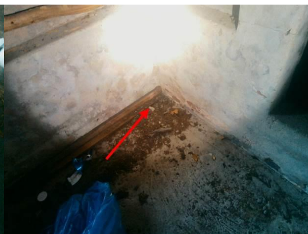
Foto 9 | restanten plafondbeplating (op de grond, inboedel en inrichting)
