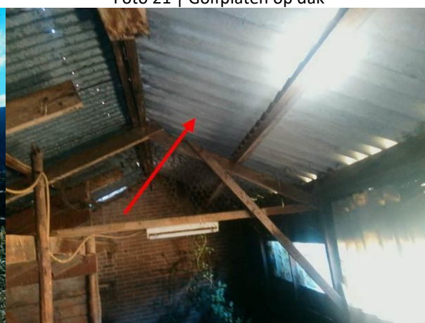
Foto 23 | Golfplaten op dak
