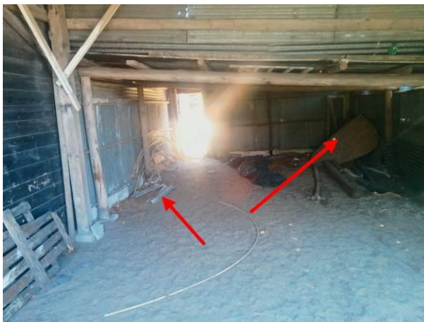
Foto 35 | restanten golfplaat / vlakke plaat
