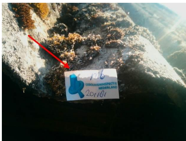
Foto 20 | Golfplaten op dak
