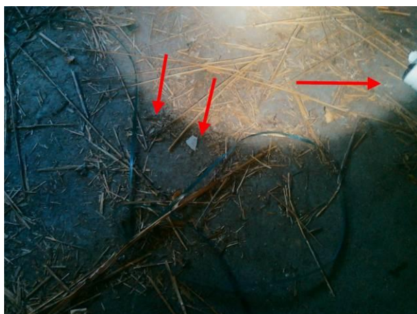
Foto 8 | restanten plafondbeplating (op de grond, inboedel en inrichting)
