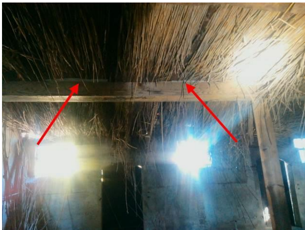
Foto 5 | restanten plafondbeplating tegen balklaag
