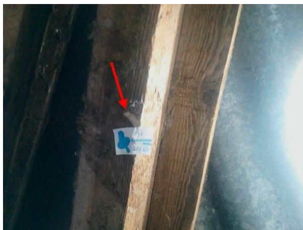
Foto 1 | restanten plafondbeplating tegen balklaag
