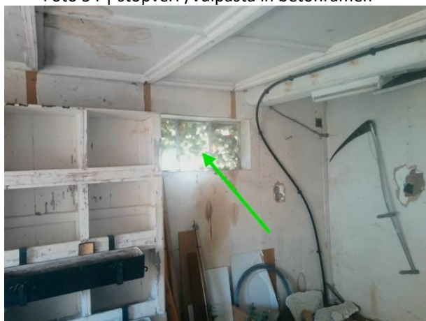
Foto 56 | stopverf /vulpasta in betonramen
