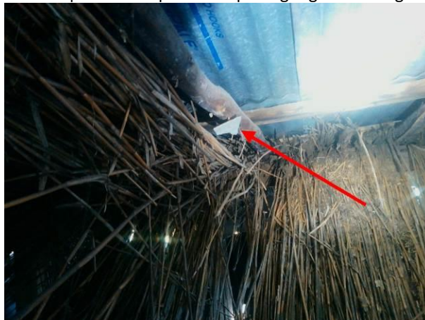
Foto 3 | restanten plafondbeplating tegen balklaag
