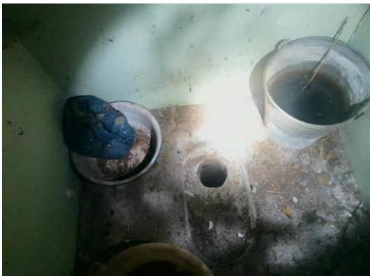
pvc buis toilet achterhuis
