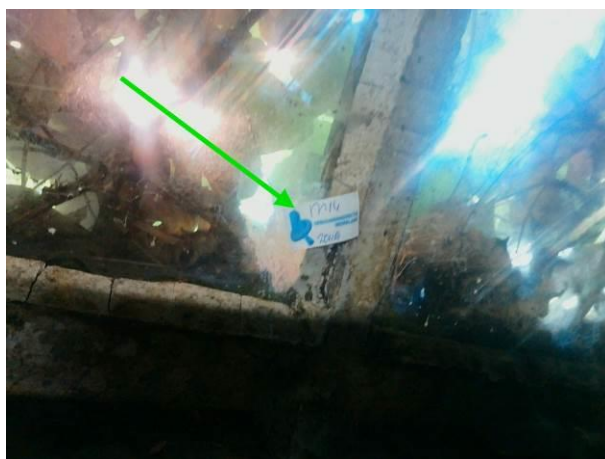
Foto 54 | stopverf /vulpasta in betonramen
