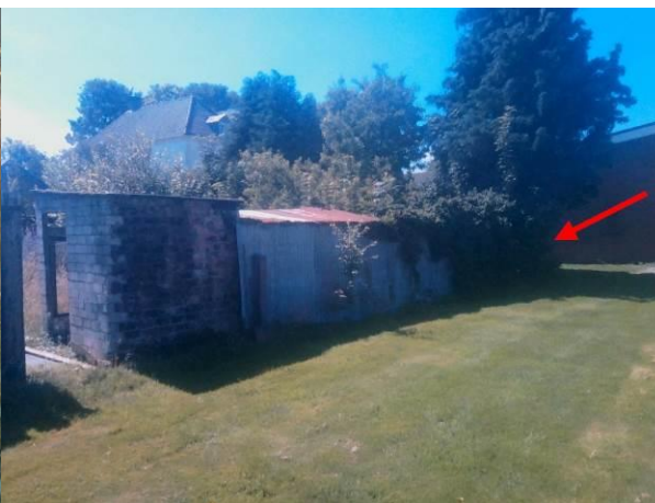
Foto 45 | restanten golfplaat in schutting
