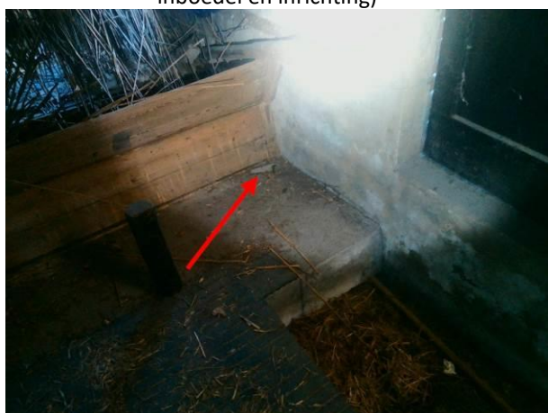
Foto 10 | restanten plafondbeplating (op de grond, inboedel en inrichting)
