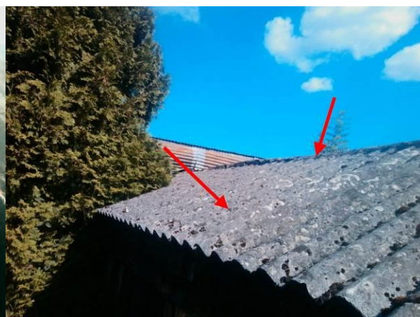
Foto 21 | Golfplaten op dak
