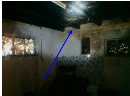
verdiepingvloer achterhuis in zeer slechte staat en niet begaanbaar
