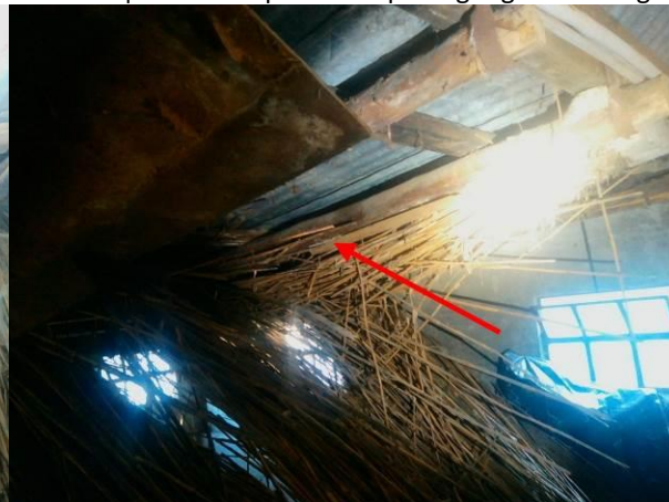
Foto 4 | restanten plafondbeplating tegen balklaag
