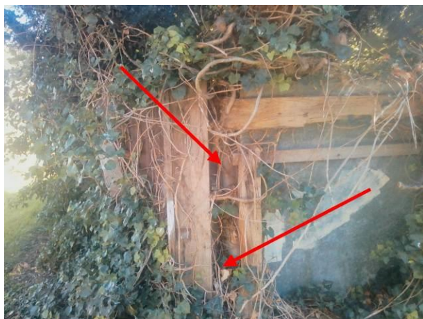
Foto 44 | restanten golfplaat in schutting
