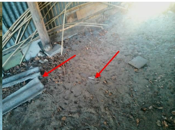
Foto 36 | restanten golfplaat / vlakke plaat
