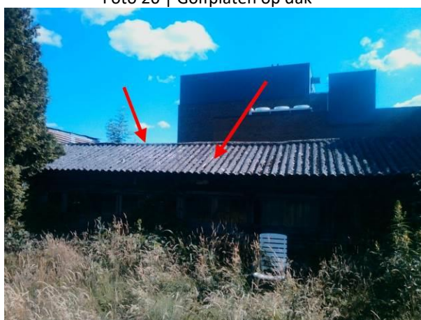
Foto 22 | Golfplaten op dak
