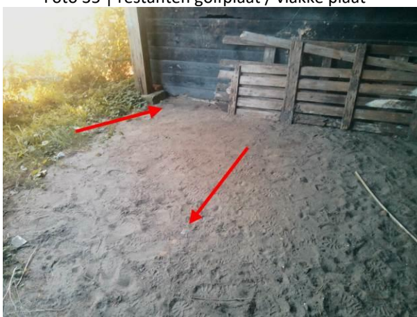
Foto 37 | restanten golfplaat / vlakke plaat
