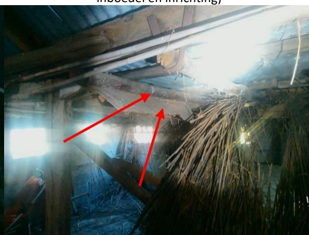
Foto 11 | restanten plafondbeplating (op de grond, inboedel en inrichting)
