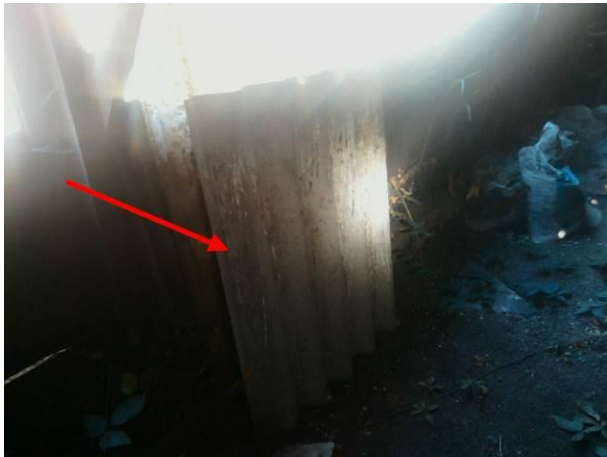
Foto 29 | restanten golfplaat / plaatmateriaal
