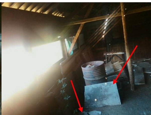
Foto 28 | restanten golfplaat / plaatmateriaal
