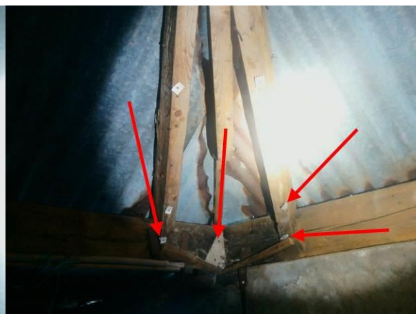
Foto 2 | restanten plafondbeplating tegen balklaag
