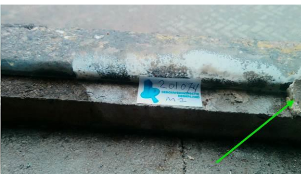
Foto 2 | Stopverf in betonnen raamkozijnen
