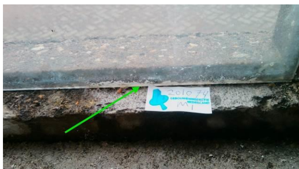
Foto 1 | Stopverf in betonnen raamkozijnen
