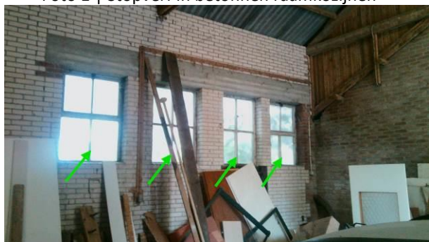
Foto 3 | Stopverf in betonnen raamkozijnen
