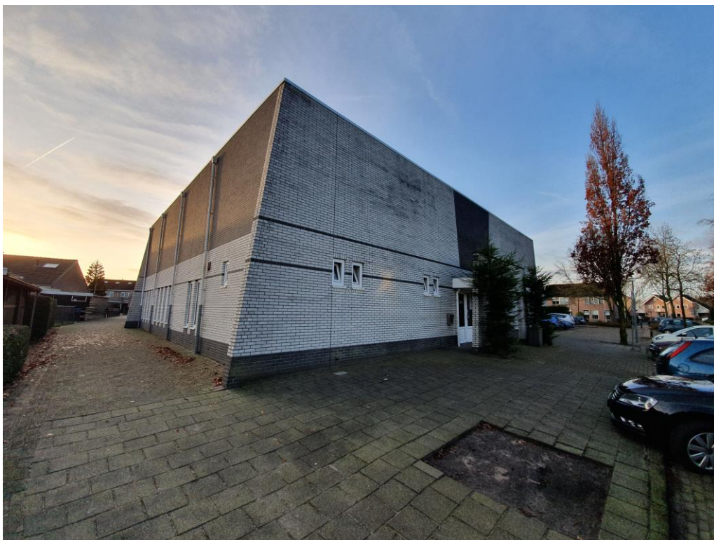
Figuur 1 Het te saneren buurthuis (de Heerdt) gelegen aan de Schiksweg 27 te Oosterwolde met vele open stoot- en dilatatievoegen.
