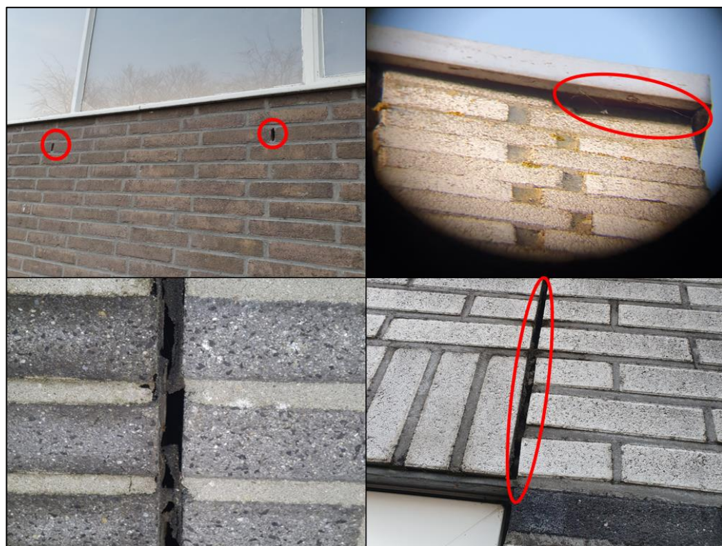
Figuur 1.3 Middels kierende daklijsten, dilatatievoegen en open stootvoegen kunnen vleermuizen toegang krijgen tot potentiële verblijfplaatsen in het dorpshuis.
