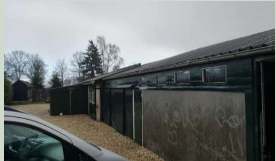
Belemmerende goten voor toegang
