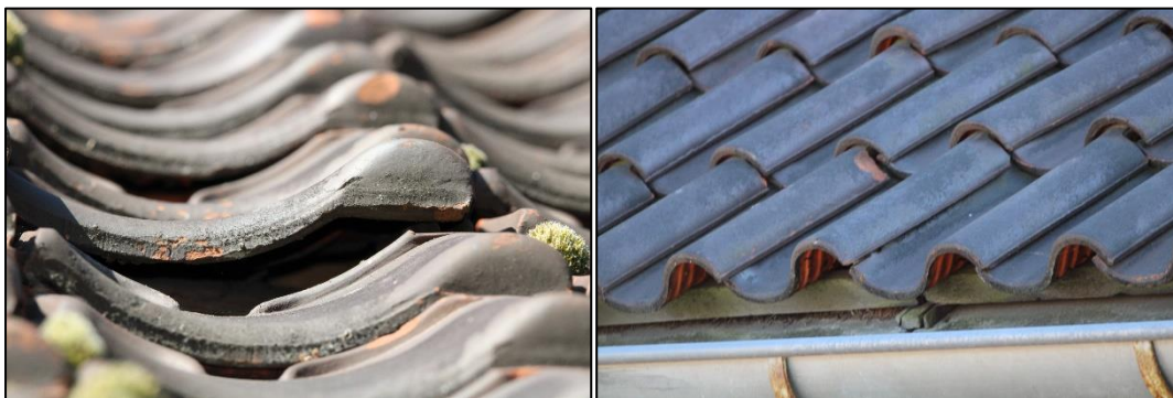
Figuur 6.1 (links): Kier onder dakpan; Figuur 6.2 (rechts): Ruimte onder dakpannen.
